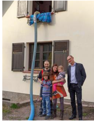
Les travaux d'isolation vont permettre à la famille Mirabelli d'améliorer significativement la performance énergétique de leur maison. PHOTO DNA
