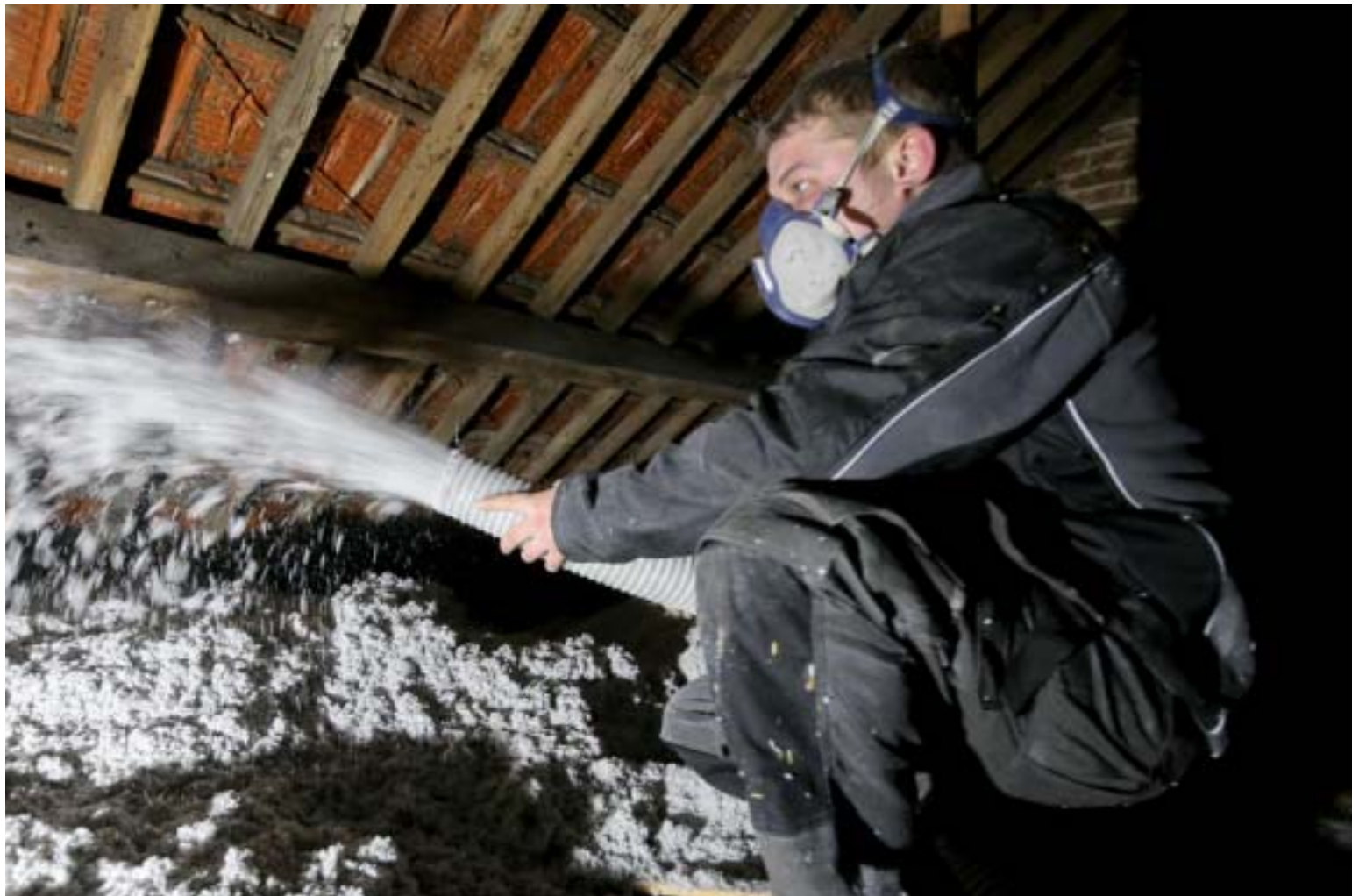
Isoler ses combles pour un euro (du m 2 ), c'est possible. Mais pas n'importe comment ni par n'importe qui. Les démarchages abusifs sont nombreux. PHOTO ARCHIVES SAMI BELLOUMI
